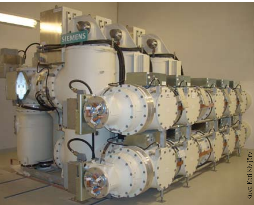
SF 6 -kojeisto Ratinan sähköasemalta. Siemensin 8DN8-tyyppinen 110kV:n GIS-kojeisto vuosimallia 2005.
